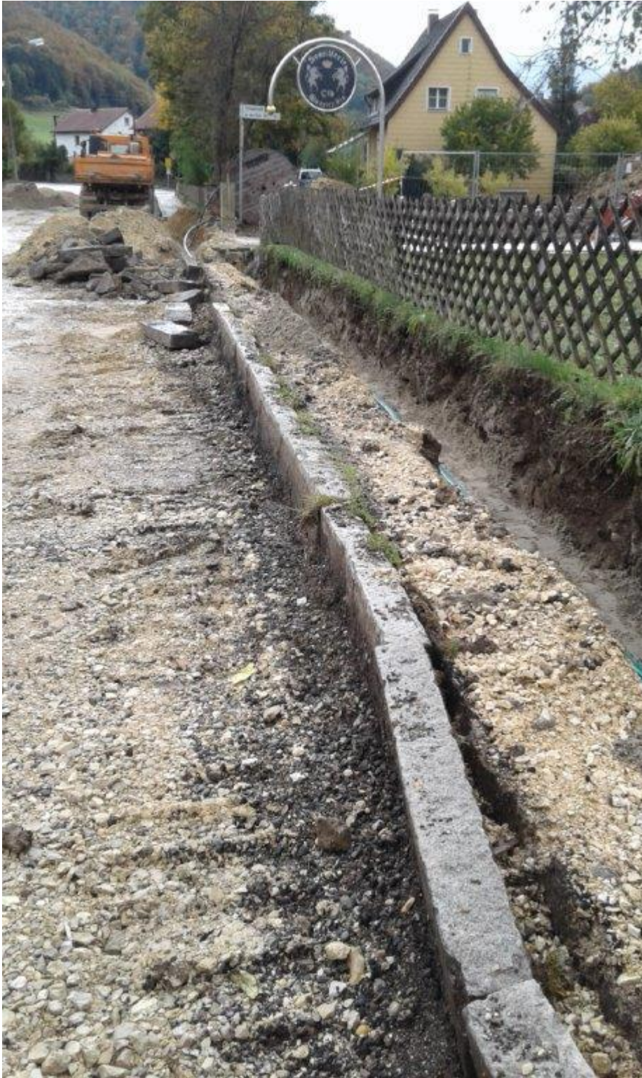
Mangelhafte, alte Randsteine wegen fehlendem Unterbeton
