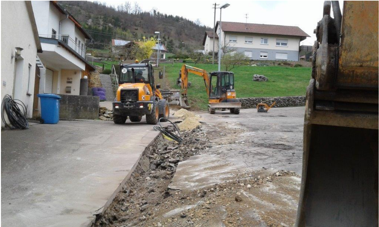
Bezirksamtshof: Probleme Unterbau
