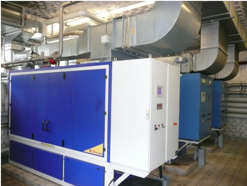
Foto 1: BHKW Raum mit BHKW 3 (vorne), alte BHKW 2 und BHKW 1 (ganz hinten)
