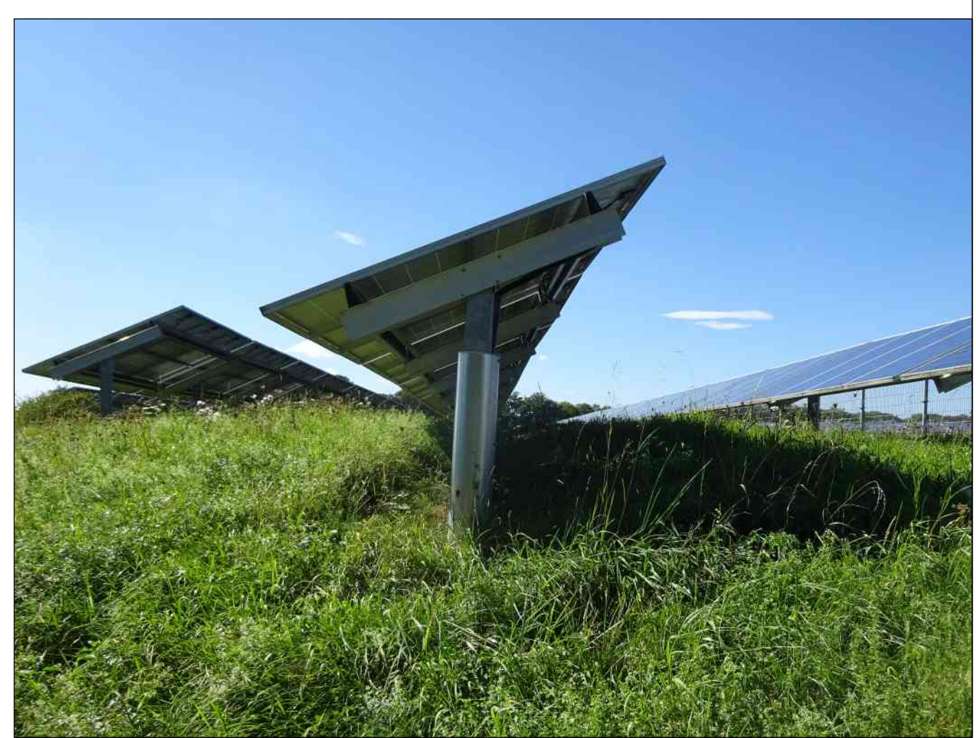
Seitenansicht bestehende PV-Anlage
