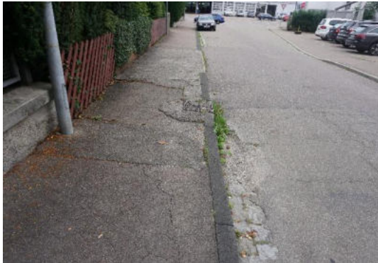
Abbildung 54: Fehlende Barrierefreiheit und Mängel im Straßenraum (Quelle: WHS 2021)
