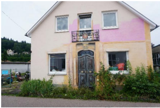
Abbildung 50: Gebäude mit substanziellen Mängeln
