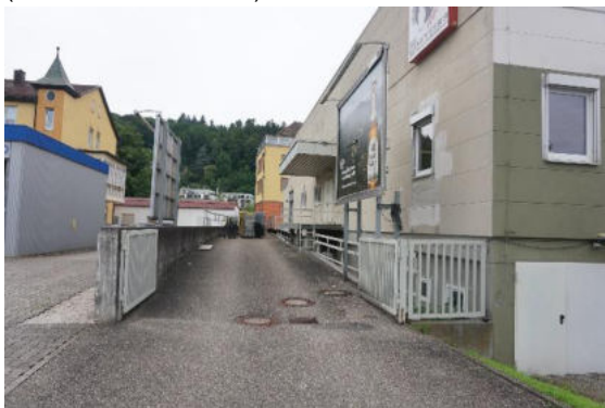
Abbildung 52: Modernisierungsbedürftiges Gebäude mit substanziellen Mängeln (Quelle: WHS 2021)
