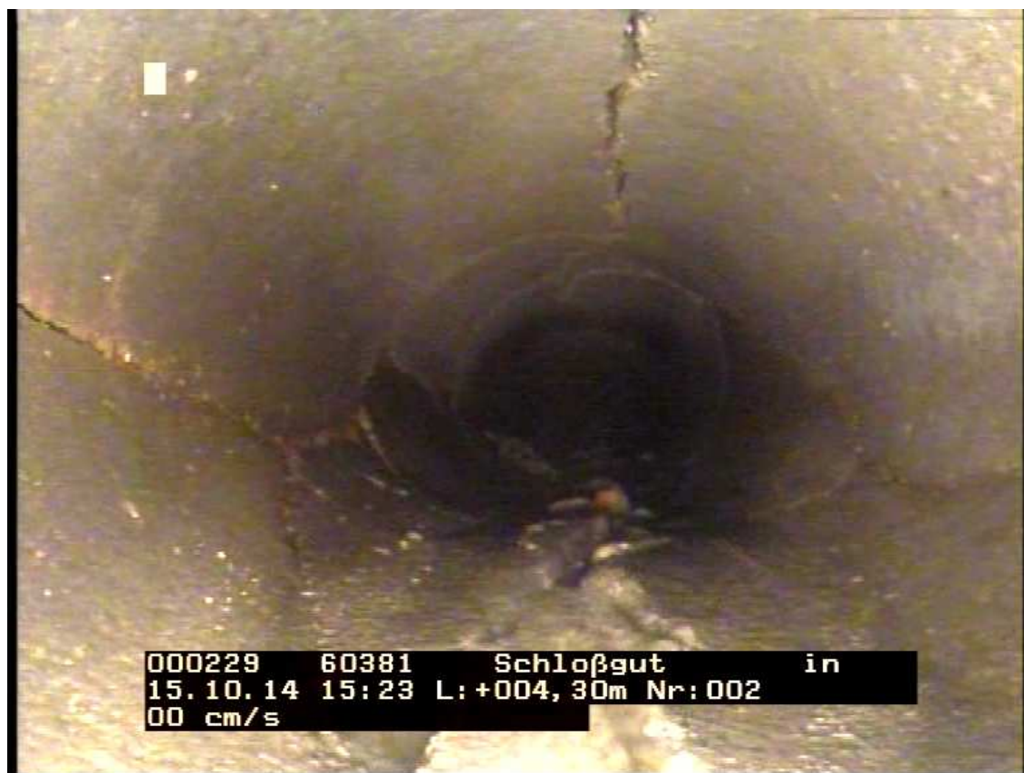
Bild 1: MW-Kanal, 60381-60358; Rohrbruch – stark deformiert
