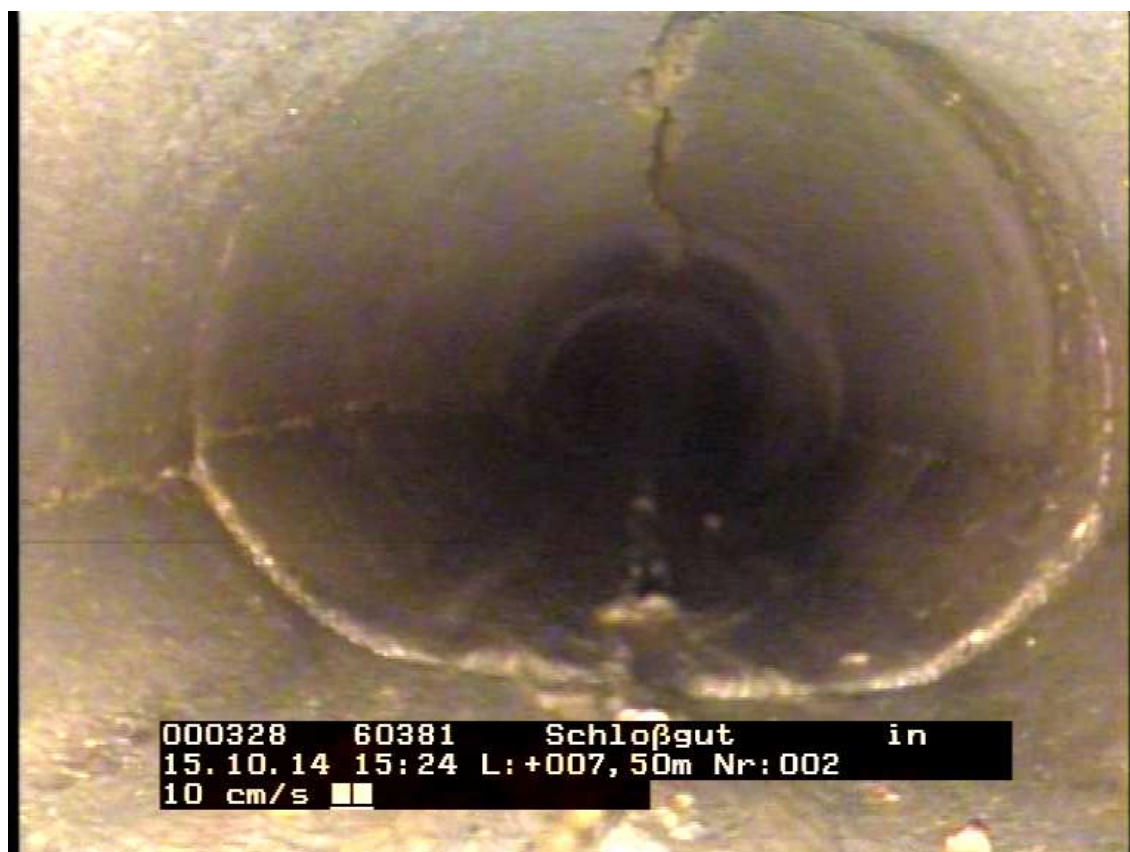
Bild 2: MW-Kanal, 60381-60358; Rohrbruch - deformiert
