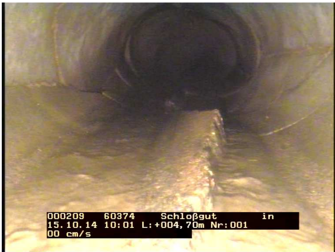
Bild 4: RW-Kanal, 60374-60373; Rohrbruch – einragende Scherbe
