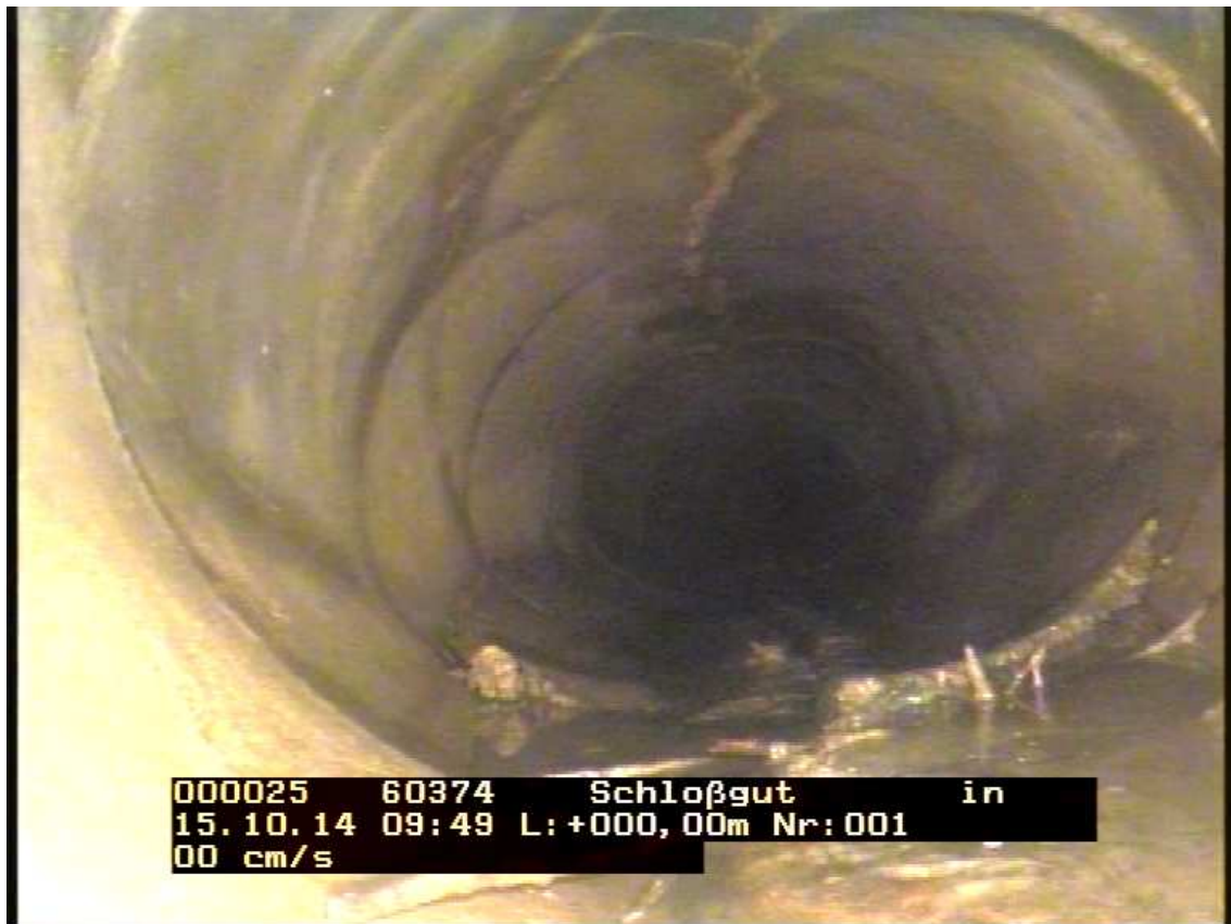
Bild 3: RW-Kanal, 60374-60373; Rohrbruch - deformiert
